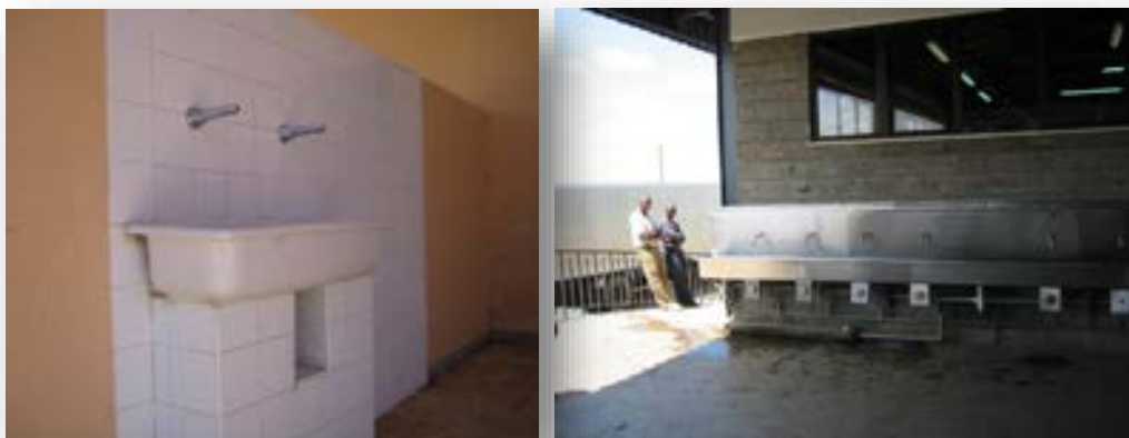
Postes de lavage des mains (Photos B. Schiffers)
