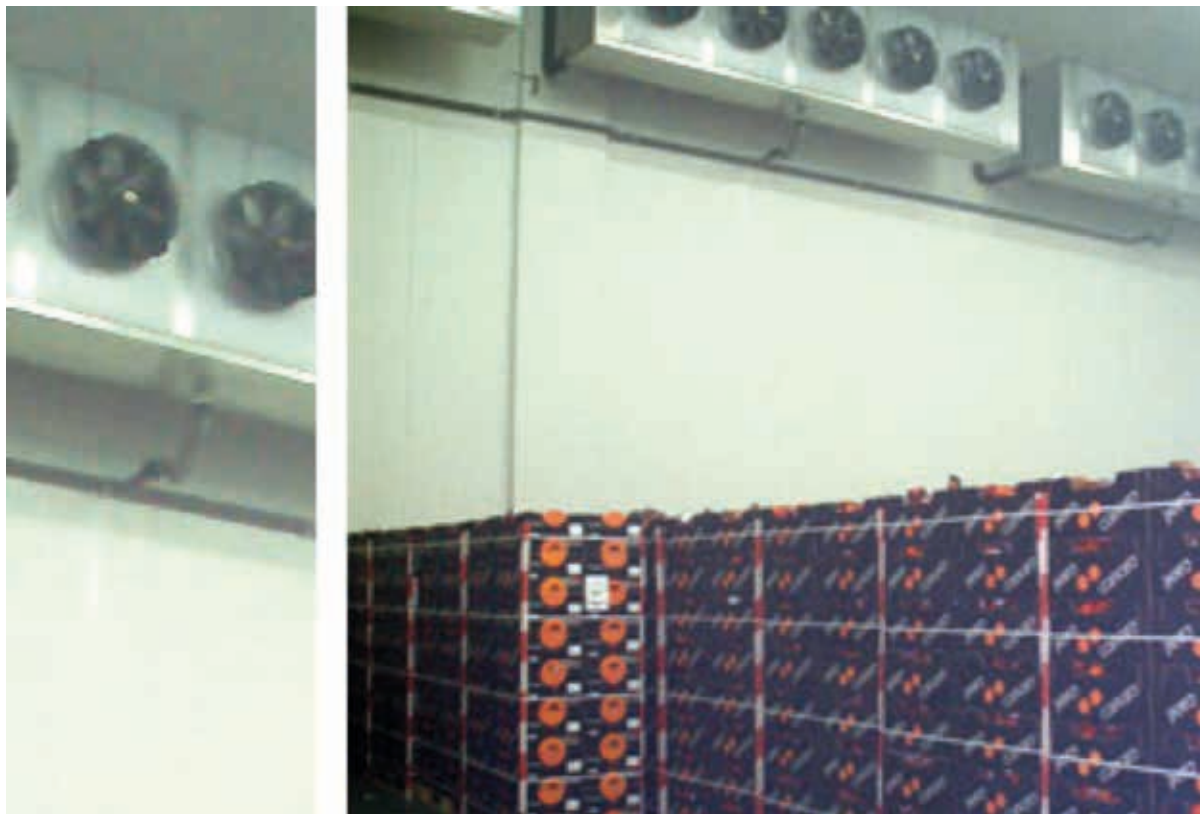
Pré-refroidissement dans un tunnel de pré-refroidissement d'oranges et de clémentines, emballées dans des caisses, étiquetées et disposées sur des palettes désinfectées, avant de passer à la chambre frigorifique où elles séjourneront jusqu'à leur expédition.
