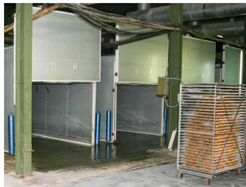
Tunnel de séchage
