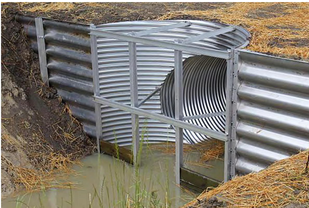
Figure 21 — Exemple d'une structure installée sur un canal principal pour contrôler le mouvement de l'eau du champ
